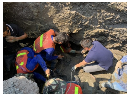
เหตุการณ์ดินถล่มในงานก่อสร้าง
